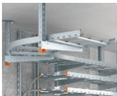
Готов монтаж Изображение на готов монтаж на кабелни стълби.
