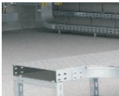
Приложение монтаж чрез повдигане Монтаж и закрепване на системата кабелни скари на разстояние от пода
