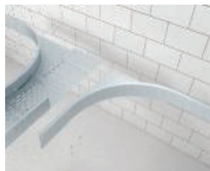
Изграждане на Т-образно отклонение с монтажнен ъглов елемент Монтаж на втория монтажнен ъглов елемент тип WEAS 110.
