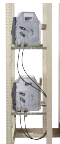
Кабелна блокировка на два прекъсвача Masterpact посредством кабели
